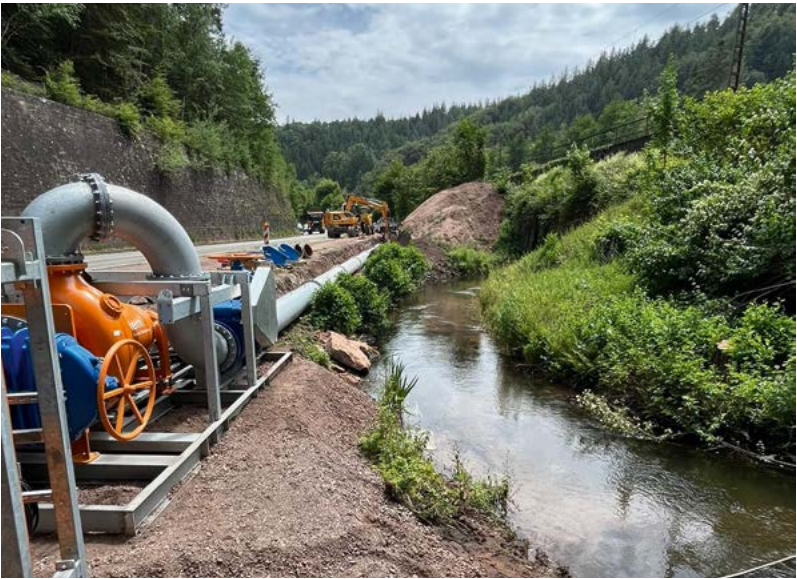
Hochspeyerbach: Leistungsstarke Pumpen sorgen für ungehinderten Wasserfluss.
